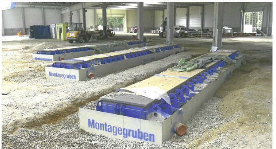
▼ Fertig verfüllte Gruben. Der Werkstattdboden wird später bis an die Grubenoberkante gegossen.
