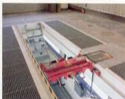
Integrierte Rüttelplatte: In die Grube lassen sich verschiedene Prüfeinrichtungen einbauen.
