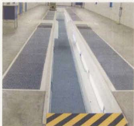
Effizienz und Sauberkeit: Die Umweltmontagegrube von Balzer.
