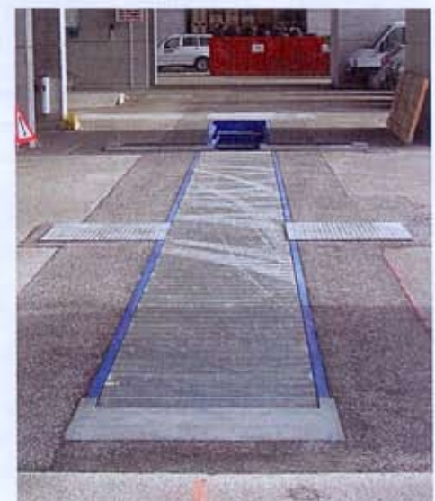
Die Grube lässt sich mit einer überfahrbaren Rollabdeckung schliessen.
